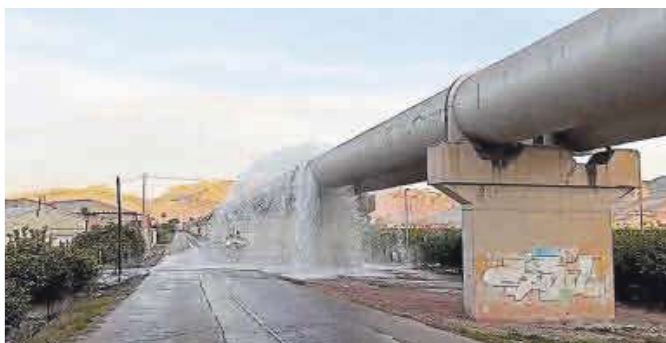
Nueva fuga de agua en los tubos del trasvase a su paso por Orihuela.
