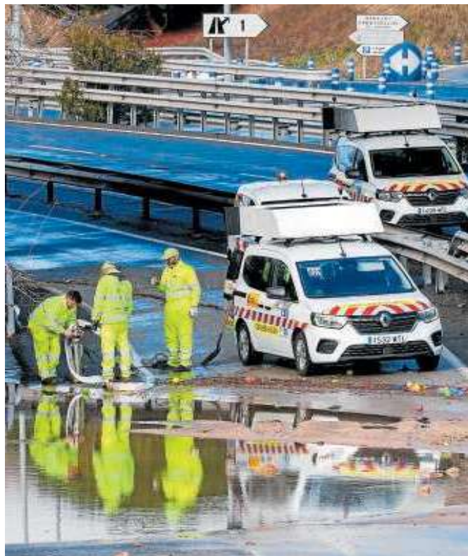
Desborde en la M-14 por la rotura de una tubería // EP
